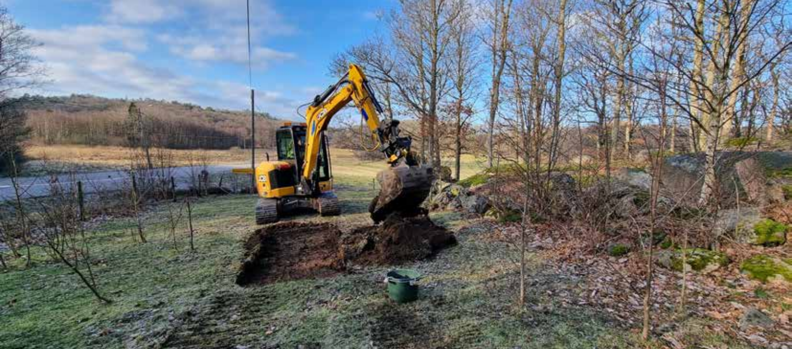
Figur 1. Schaktning i hagmark på en av de sandiga ytorna. Foto Johanna Lega
