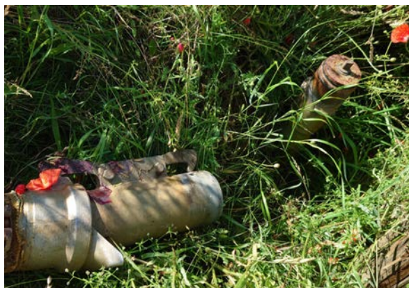
Brunn 13400175 används endast till trädgårdsbevattning. Kapacitet 71 kbm/tim.
