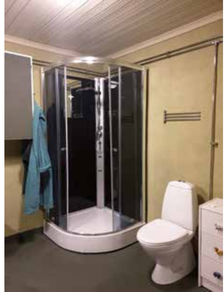
Badrummet har lergolv och tre lerputsade väggar. Den fjärde väggen består av pärlspont för att tvättställ och elledningar enkelt skulle kunna monteras. Foto: Susanne Lindström.
