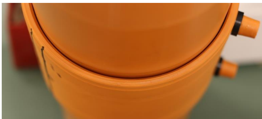
Figur 4. Glapp på PP elektrosvetsmuffen 2 skarv 2.
