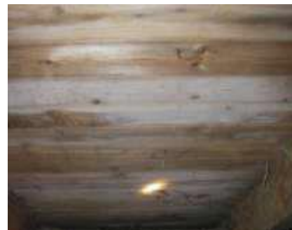
Bild 14. Missfärgningar som uppkommit efter tilläggsisolering. Upptäcks fuktutfällningen tidigt kan åtgärder göras utan att omfattande skador hinner uppstå. Primärorsaken till skadan är ett otätt vindsbjälklag i kombination ett invändigt övertryck som innebär att fuktig inneluft tillförs vindsutrymmet. (Foto: Anneling Tobin Consult AB)
