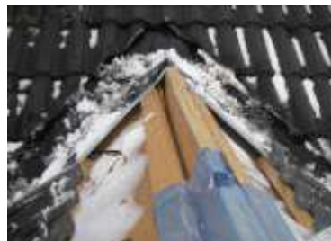
Bild 19. Yrsnö på vindsutrymmet är en signal om brist som bör påtalas men som inte hindrar fortsatt isoleringsarbete. (Foto: Anneling Tobin Consult AB)
