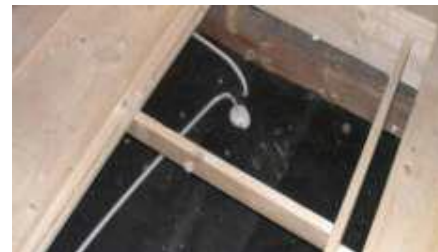
Bild 8. Att lufttäta befintliga vindsbjälklag är tidsödande och svårt men större otätheter bör alltid åtgärdas. Total lufttätet uppnås aldrig varför åtgärden endast är ett komplement till åtgärden att säkerställa god ventilation inomhus. (Foto: Anneling Tobin Consult AB)
