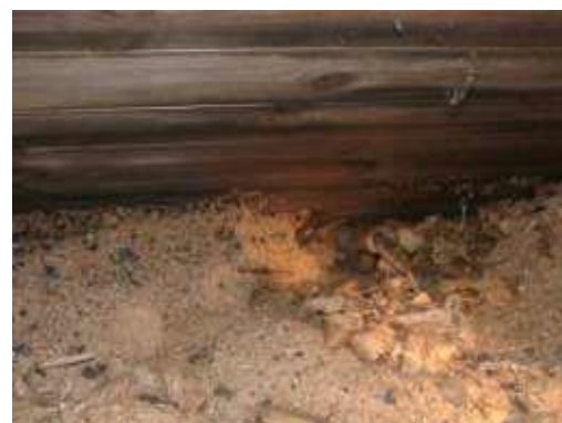
Bild 7. Tecken på uppträngande fuktig inomhusluft som kondenserar mot underlagstakets kalla yta. Tilläggsisolera inte utan att först ha åtgärdat problemet. Lösningen är inte fler ventiler i yttertaket utan kräver oftast en översyn av ventilationen inomhus och ev. förbättring av lufttätheten i vindsbjälklaget. (Foto: Anneling Tobin Consult AB)
