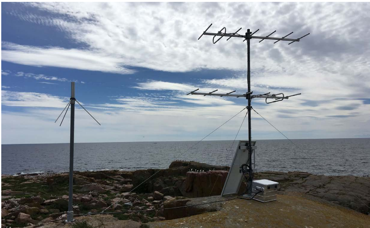
Figur 7. På Bonden placerades radiomottagarstationen uppe på berget nedanför fyren. På masten till vänster en rundstrålande antenn och på masten till höger två riktade Yagi-Uda-antenn. I brist på nätström försågs stationerna med ström via solpanel. FOTO: NICLAS FRITZÉN.
