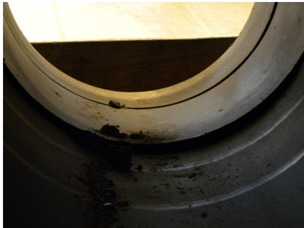
Figur 2 Invändig vy som visar en kraftig kantförskjutning av det ena röret i muffen.
