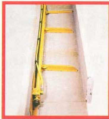
Enkelskrapor i kulvert.
