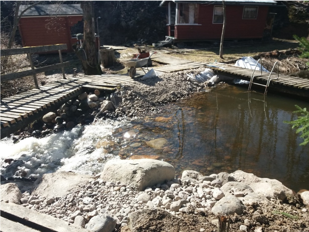
Kuva korjatulta padolta huhtikuulta 2018 (kuva Sami Soininen / ELY-keskus)
